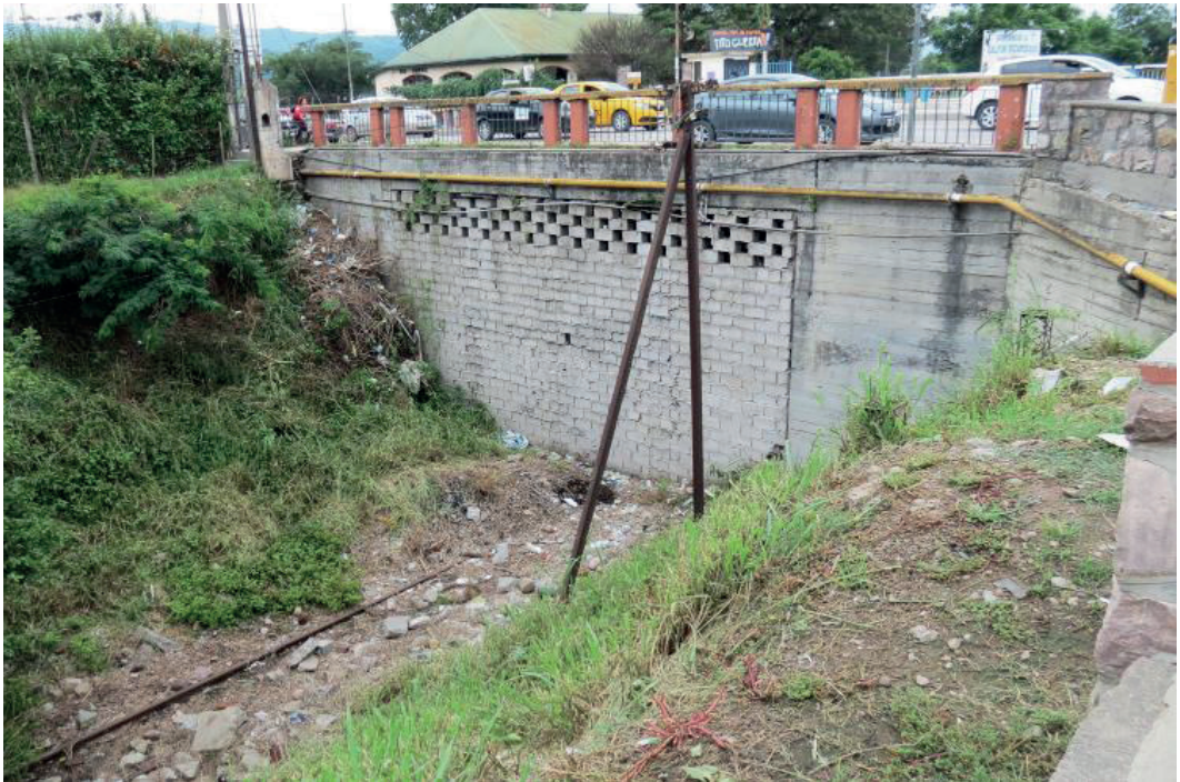
Figura 4: Paredón trasero del depósito ubicado bajo el puente lindante a la estación S.S. de Jujuy y bloqueo de vías.
