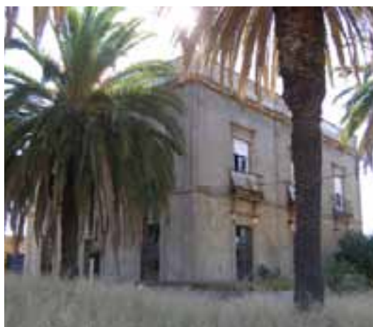
Figura 2. Rehabilitación de la antigua Casa de Dirección en el poblado minero de Cueva de La Mora
