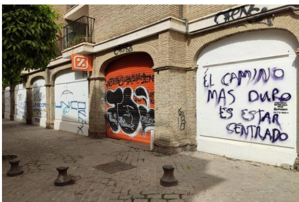
Imagen 6. Reincidencia de pintadas en una fachada marcada tras la acción de la nueva Unidad Antigrafitis en una fachada de la calle Almirante Espinosa.
